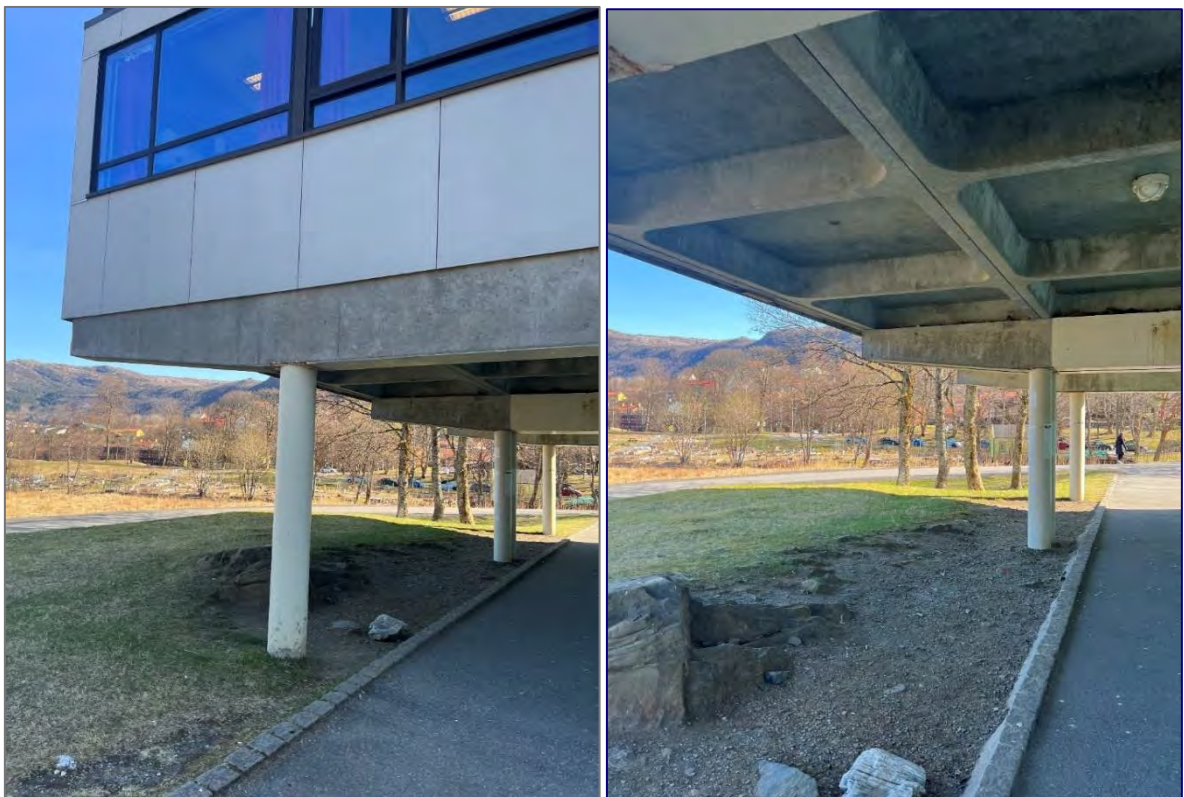
Figur 26. 1. etasje på U-blokk danner en utkraget del. Her ser man også tydelig kassetthimling, her i upusset råbetong.
