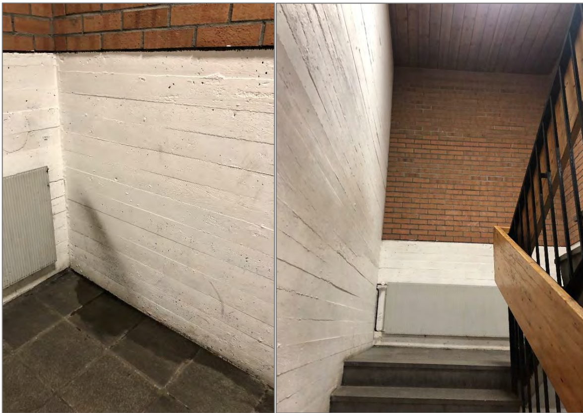
Figur 55. Eksempel på vedlikeholdsetterslep trapp
