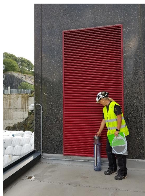
Figur 3. Ventilasjon til slaggbunker.
