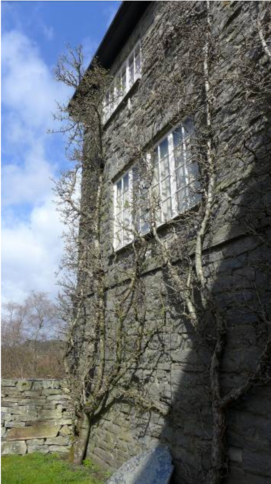
Figur 7. Gråsteinsmurene i den nordvestlige fløyen vokser nærmest opp fra bakken, og fortsetter ubrutt i sin rene vertikale form helt til gesims (Foto: Byantikvaren 2015).
