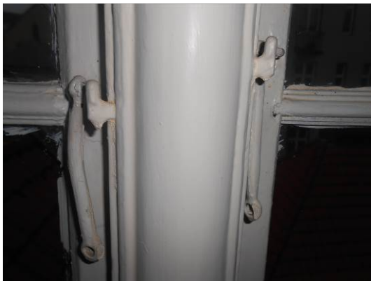
Figur 17 (venstre): Vindu med stormkrok (Foto: Byantikvaren, Bergen kommune 2015).
