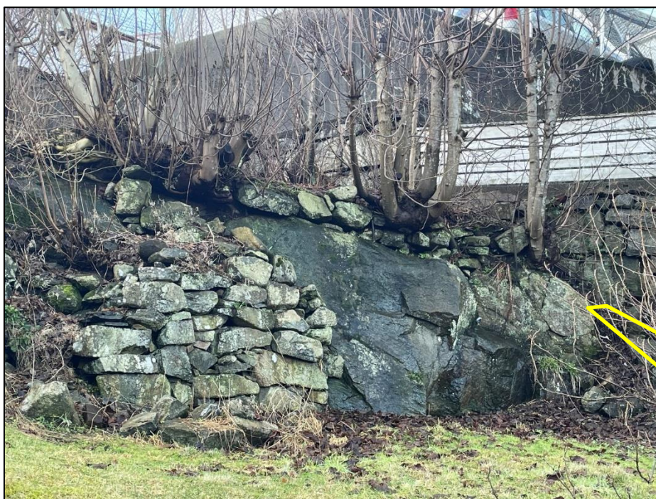
Figur 8. I nedre del av trase 3 er det i ytterkant av planlagt trase berg. Gul markering viser plassering av nedre del av planlagt trase i bakkant av blotning. Berget fremstår massivt, men mur i forkant fremstår ustabil og i dårlig stand.
