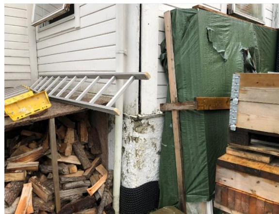
Figur 5-8 Grunnmuren har noen mindre sprekker.
