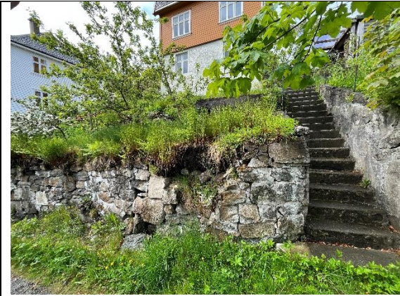
Bilde 7: Muren som er delvis rast.
