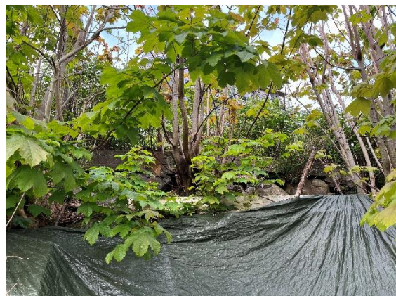
Bilde 10: Bilde viser samme mur og behov for rekkverk
