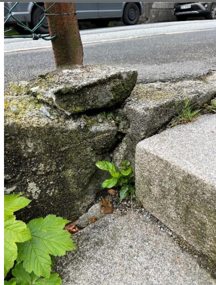
Bilde 3: Brudd i øvre del av muren.
