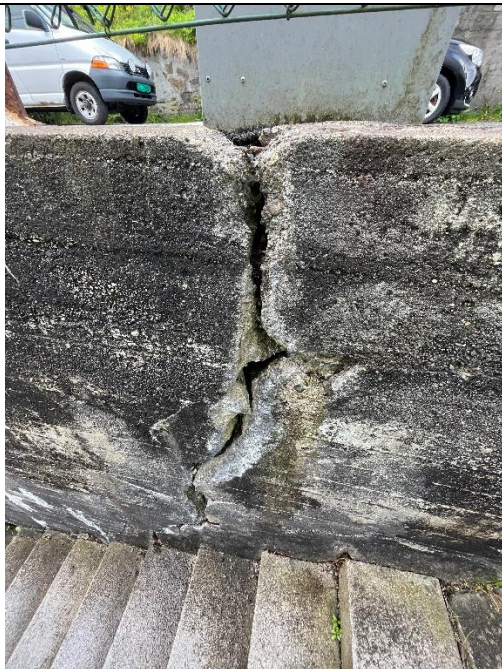
Bilde 4: Gjennomgående sprekk med liten armering i betong.
