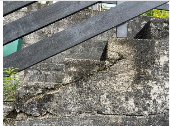
Bilde 18: Skader under betongtrapp.
