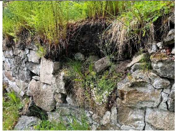
Bilde 8: Nærbilde som viser skadeomfang i muren.
