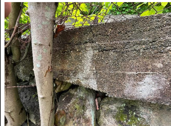
Bilde 9: Ødelagt betongmur delvis uten opplegg og manglende rekkverk
