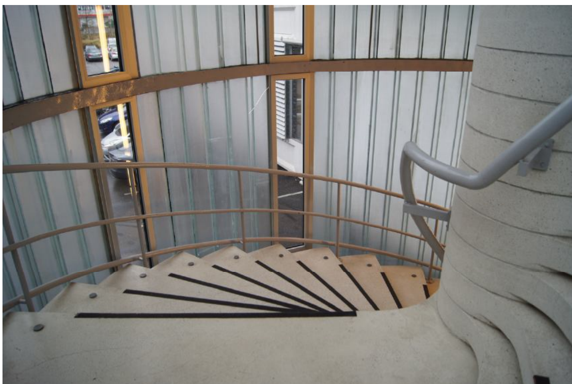
TRAPPEHUSET VAR ORIGINALT IKKJE UTSTYRT MED VINDAUGE OG REKKVERK.
