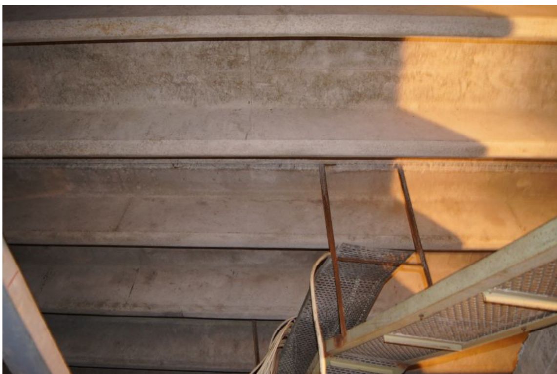
TAK I BLINDKJELLAR MED ORIGINALE BETONGELEMMENT.
