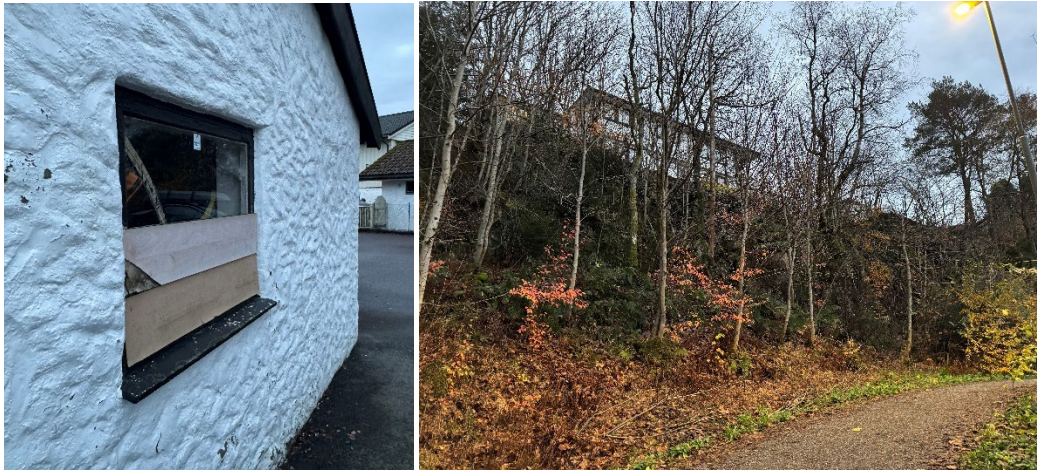
Figur 4-20T.v.: Defekt vindu på garasjen. T.h.: Nebbestølen 93 troner øverst på kollen, skjult bak vegetasjon. November 2025.
