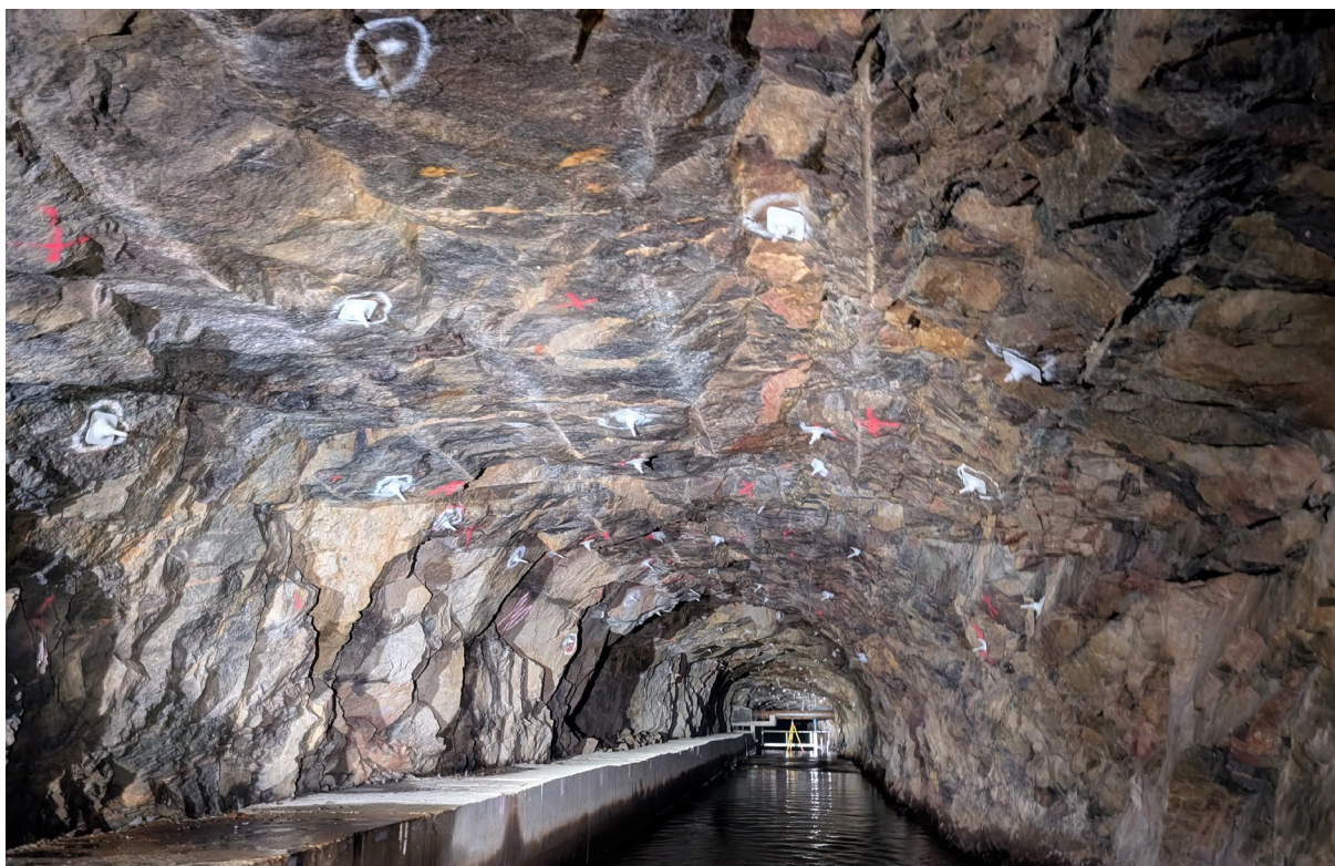
Figur 10 Sprekkemønsteret endrer seg lite lengre sør for nøkkelpunkt 3. Bildet er tatt ved P50.
