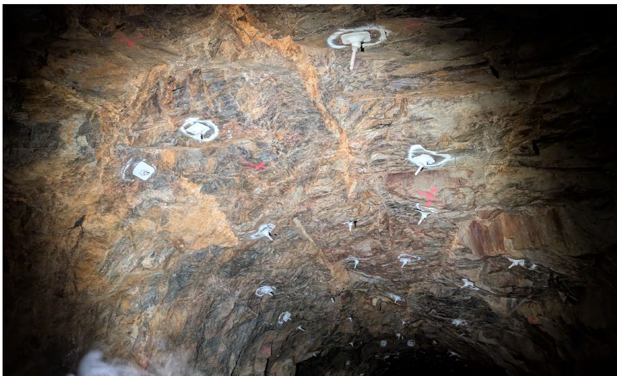
Figur 9 Økning i antall sprekker lengre sør i tunnelen. Bildet er tatt ved P80.
