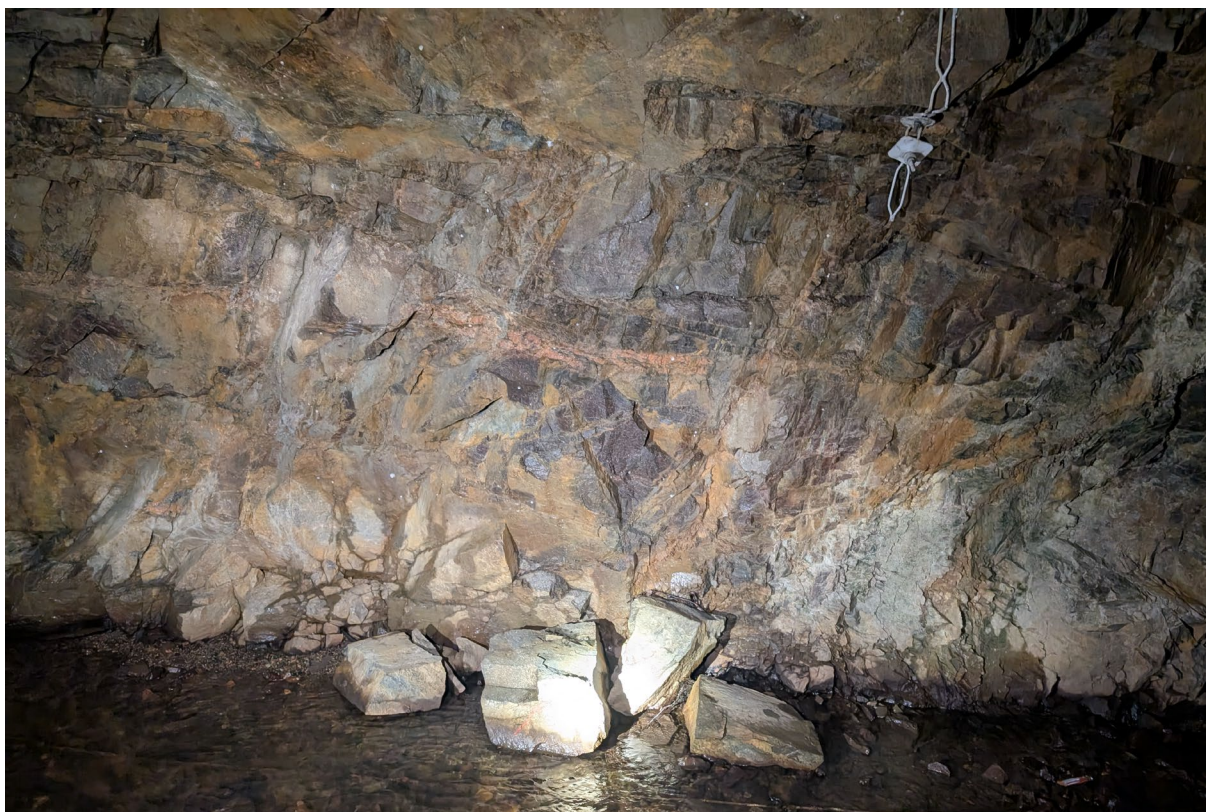
Figur 7 Viser steinblokker som har falt ned fra taket.
