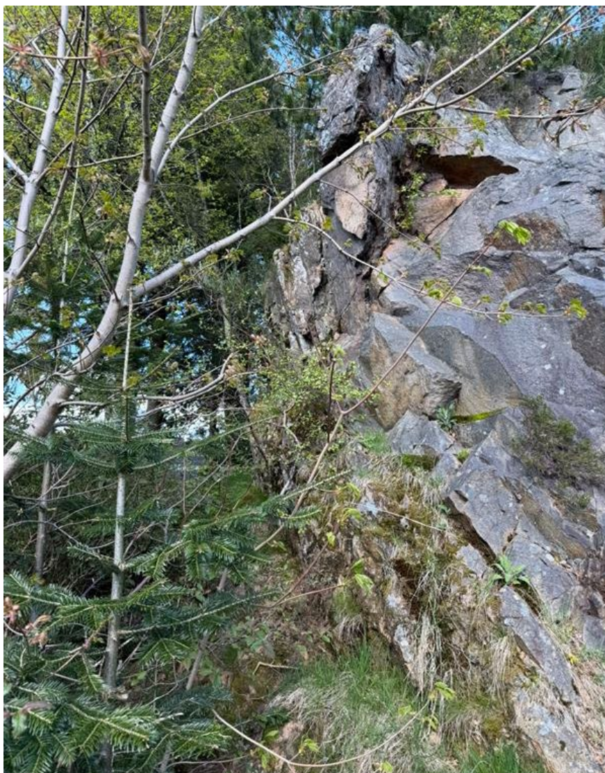
Figur 3 Observerte blokker med potensiale for utglidninger under sprengningsarbeider. Nederst i skråningen observeres hovedsprekkeplanet som faller mot nord-østlig retning med et fall på omtrent 70 grader.
