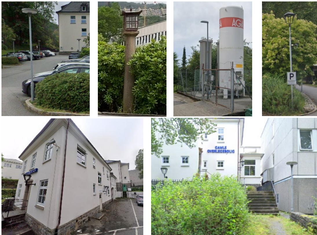
Bilder fra SLA (LARK), som viser eksisterende belysningsarmaturer i området rundt Årstadhuset.
