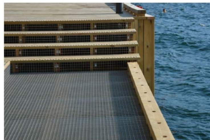
Gitterrister er et tiltak for å hindre skade på kaianlegg som følger av kraftig sjø
