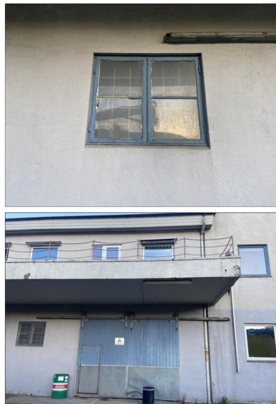
Figur 43 Opprinnelige detaljer. Øverst: vindu i 1. etasje. Nederst: balkong, dørport og vinder med sprosseinndeling og blå detaljer. . Fotografi: Asplan Viak, 2025
