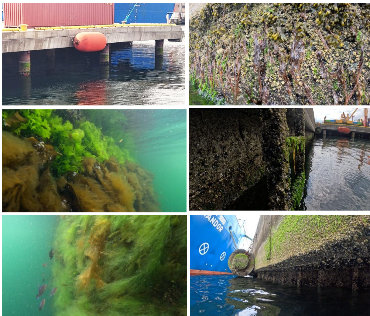
Figur 5-5 Artssamfunn i fjæresonen og øverste sjøsonen på kaivegg ved Dokken. Overhengende kai med pilarer i kontainerområdet (øverst t.v.). Øverste fjæresone på stasjon C (øverst t.h.), nedre fjæresone på stasjon B (andre rekke t.v.) og, stasjon E (t. h.). Nederst: Stasjon E (t. v.) og Stasjon F (t. h.). Foto: Christiane Todt.
