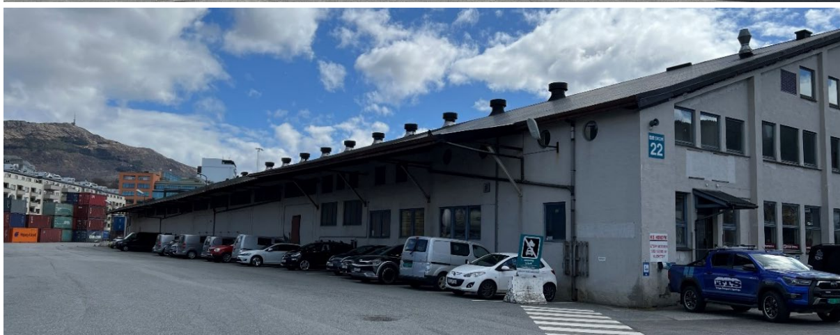
Figur 3-16 Skur 22 i midten og nederst. Fotografier tatt under befaring, 2024.
