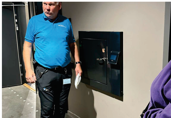
Bilder fra befaring til Vestlandshuset, august 2024. Nedkastpunkt har en kodeløs som kommunisere avfalls typer for sortering ned til det riktige kontainere i kjeller. Lite lyd på befaring. Nedkast enhet var i et åpent areal.
