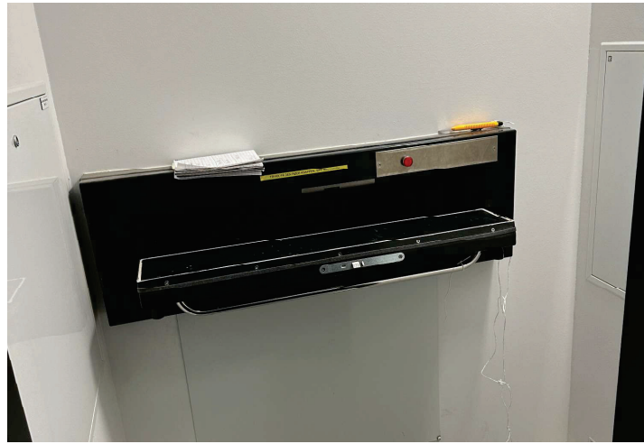
Bilder fra befaring til Vestlandshuset, august 2024. Innkast punkt til papp må være i et branncelle. På befaring var det veldig lite lyd fra porten når den var åpent.
