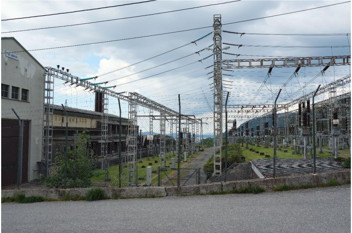
Figur 3 - Transformatorstasjon på Montana endrer spenningen fra transmisjonsnettet til distribusjonsnettet. Transformatorstasjonen er et godt eksempel på hvor arealkrevende ny nettkapasitet kan være og hvilken infrastruktur som er nødvendig i for et fungerende nett.
