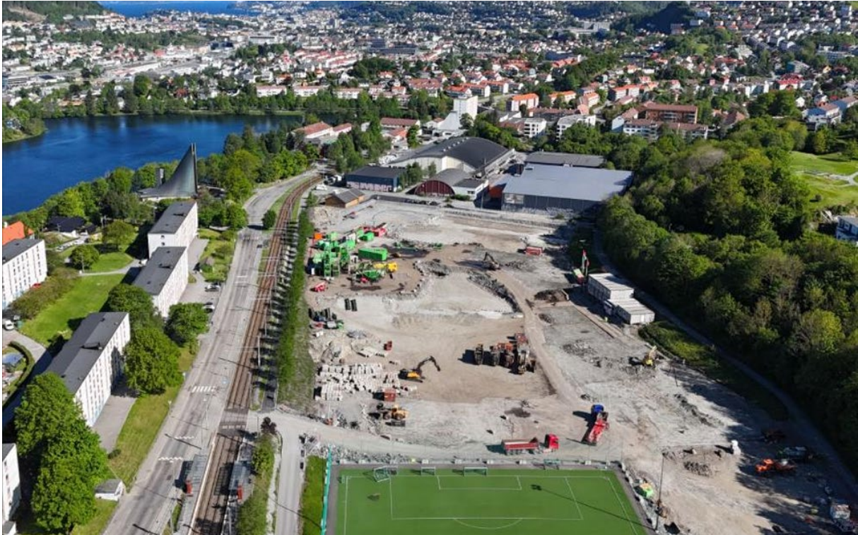
Figur 3-17: Dronefoto er tatt mot nord, i mai 2025, og viser tilnærmet ferdigstilt anleggsområde og nedrigging. Turnkassen og Gimlehallen sees i enden av det utgravde området, bygning nummer 1 og 2 fra venstre. Slettebakken bybaneholdeplass i nedre venstre bildekant, Tveitevannet sees i nordvest.
