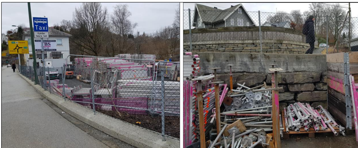
Figur 7: Bilder fra befaring 23.02.2023. Til venstre: bilde tatt i retning mot vest-nordvest, til høyre: bilde tatt i retning mot sør, av eksisterende tørrmur mot fortau v/ E39.
