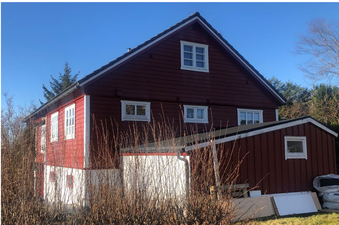
Figur 5-28 Sørøstre og sørvestre fasade. En ser det er satt inn små vindu i kjelleren til forskjell for det som viser i approberte tegninger. Dagens fasade i underetasjen ser ut til å være speilvendt i forhold til tegningene. Foto: AKB, Opus 2021.
