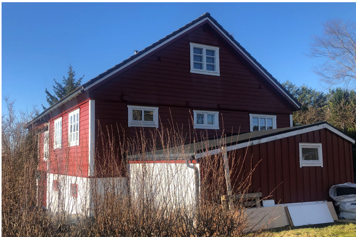
Figur 4-6 Sørøstre og sørvestre fasade. En ser det er satt inn små vindu i kjelleren til forskjell for det som viser i approberte tegninger. Dagens fasade i underetasjen ser ut til å være speilvendt i forhold til tegningene. Foto: AKB, Opus 2021.
