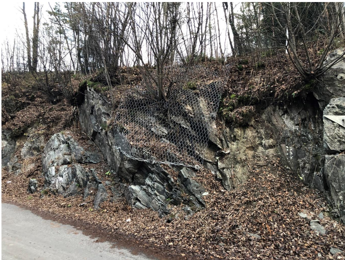
Figur 6. Undergraving og utfall av løsmasser langs skjæringskant lengst nord i kartleggingsområdet.
