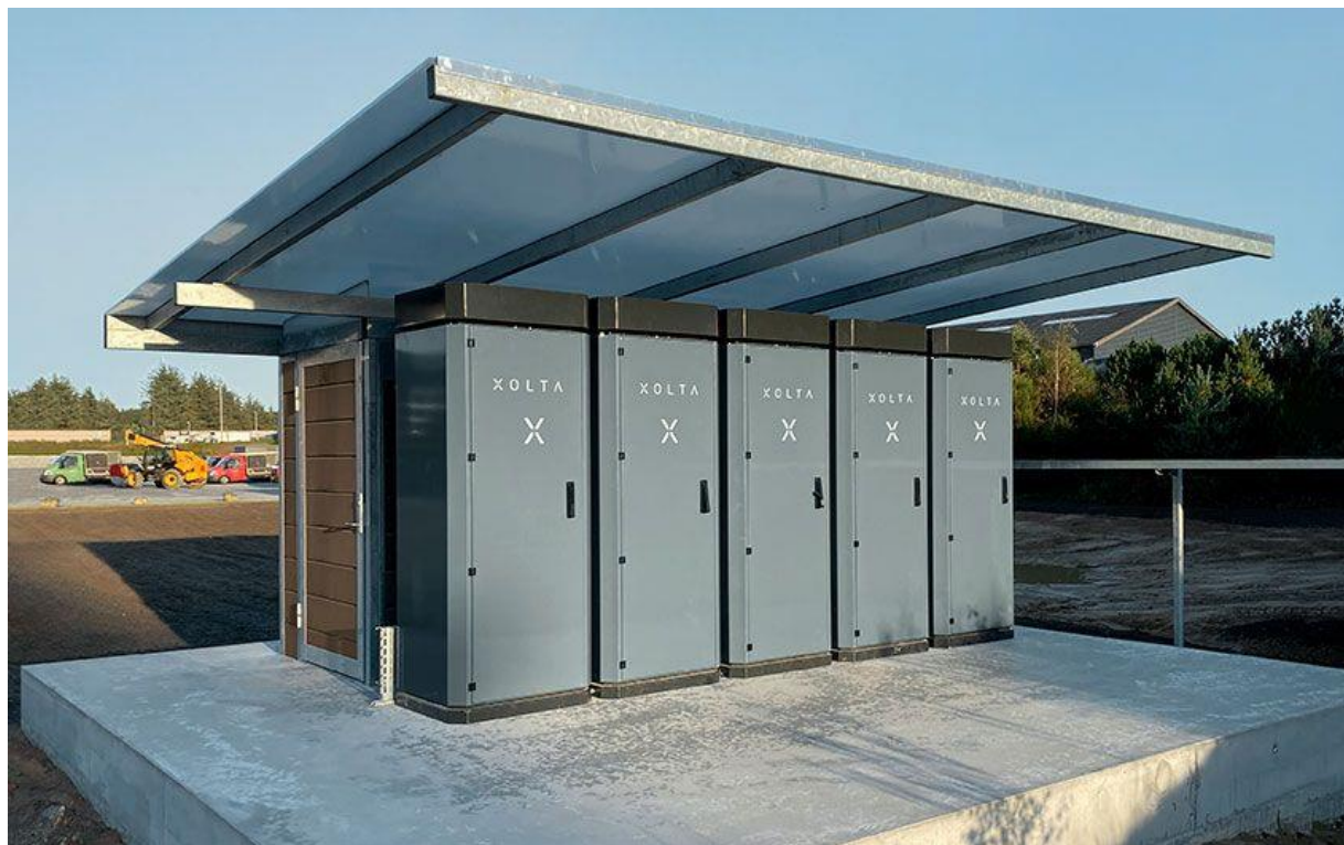
Figur 25: Utendørs modulbasert batteriinstallasjon. Foto: Haarup Maskinfabrik A/S, Danmark.
