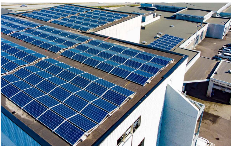
Figur 8: Eksempel på øst/vest orientert solcelleanlegg.
