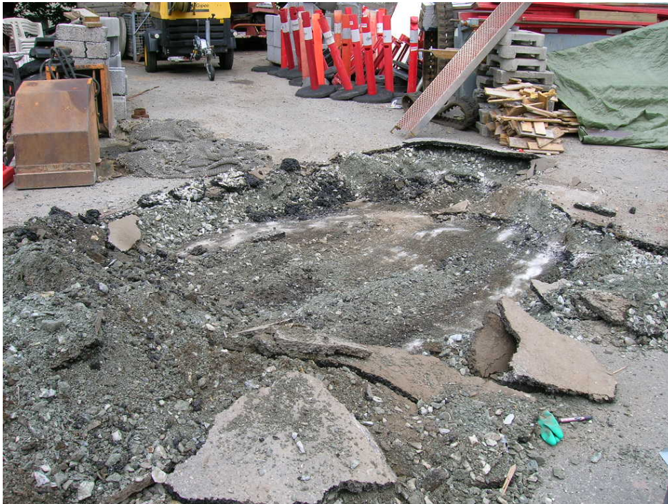
Figur 3: I PG 2 ble antatt berg påtruffet ca. 0,1 m under terreng.
