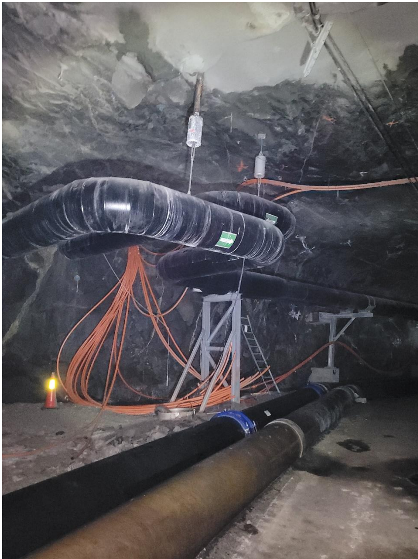
Figur 2 Fjernvarme (øverst) og vannledninger (langs såle) i nisjen.
