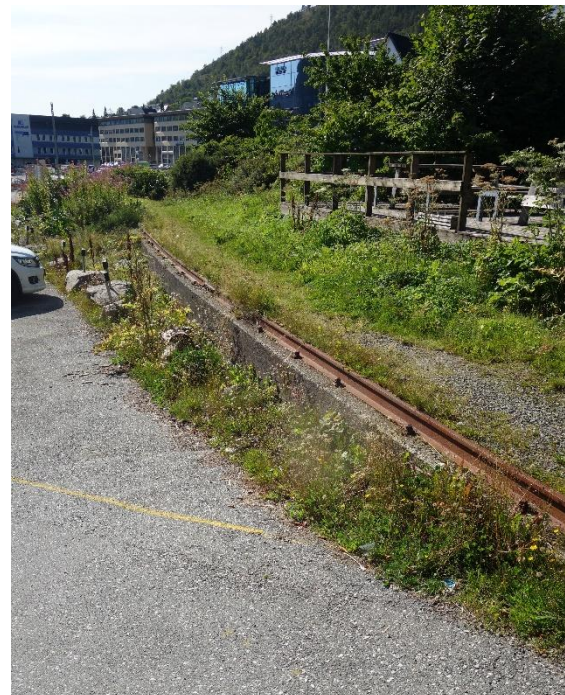
Figur 3-8. Det er synlige jernbanespor i området i dag. Dette sporet ligger høyt i terrenget, og har svak fundamentering uten sviller. Trolig er det et industrispor fra etterkrigstiden som ble brukt for å knytte Mjølner til Vossebanens nye trasé i tunell under Fløen.
