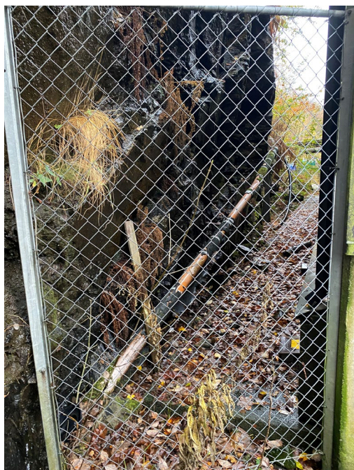
Figur 6 - Passasjen er svært smal. Bilde tatt fra nord mot sør i 2022.
