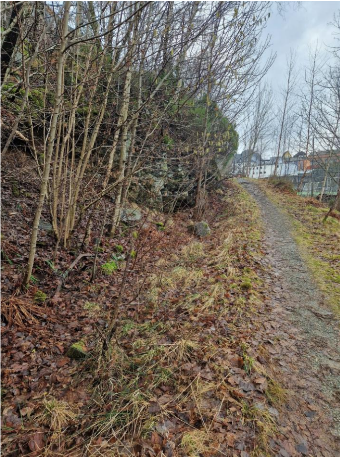
Bilde 3. Skråning i sørøst med små bergpartier og fare for remobilisering. Observert nedfall i grøft. Sett mot sør.
