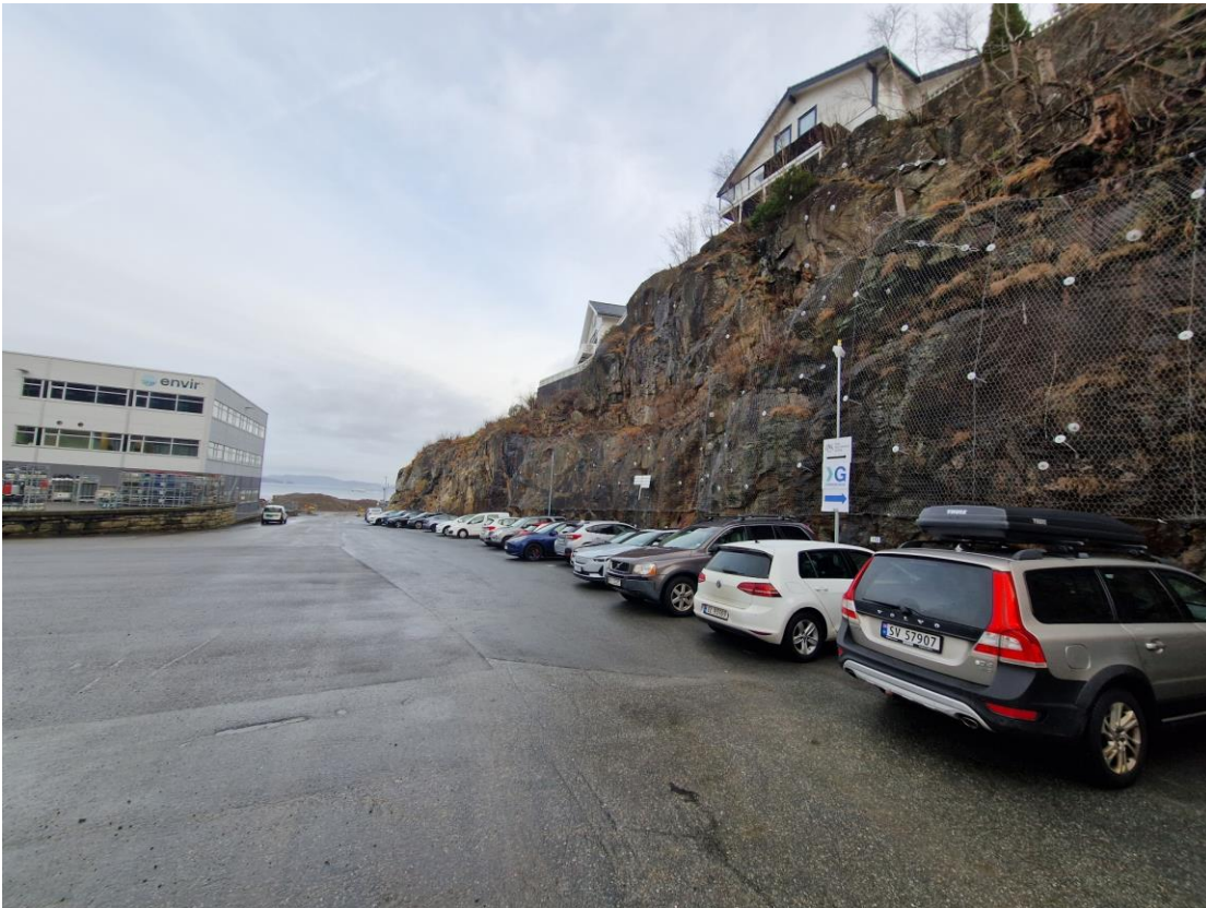
Bilde 7. Sikringstiltak i nedre del av skråningen og noe i øvre. Sett mot nord.
