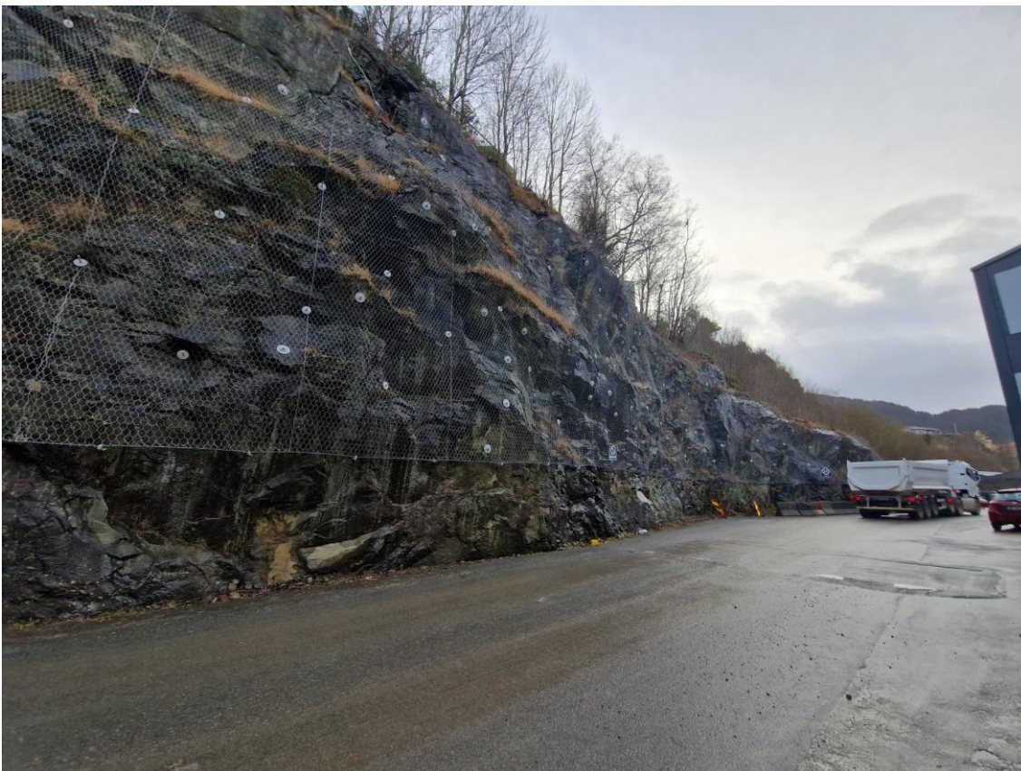
Bilde 6. Sikringstiltak som er vurdert å forhindre nedfall med sannsynlighet 1/5000. Sett mot sør.
