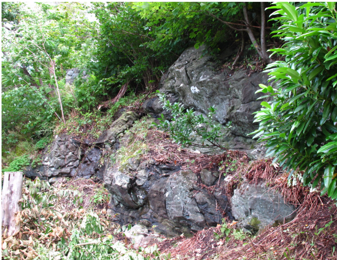
Bilde 2. Deler av bergskjæringen bak tomten. De avløste bergpartiene må sikres med sikringsbolter før bygging. Det vil bli behov for bergsikring andre steder på tomten, men mye vegetasjon vanskeliggjorde bildetaking.
