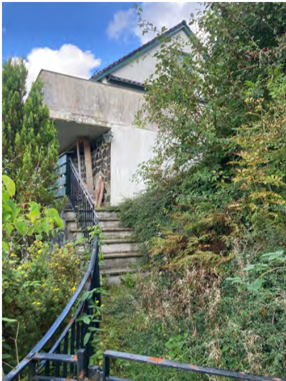
Tilkomst frå Øvre Fantoftåsen. Vi ser at altanen er midlertidig støtta opp.
