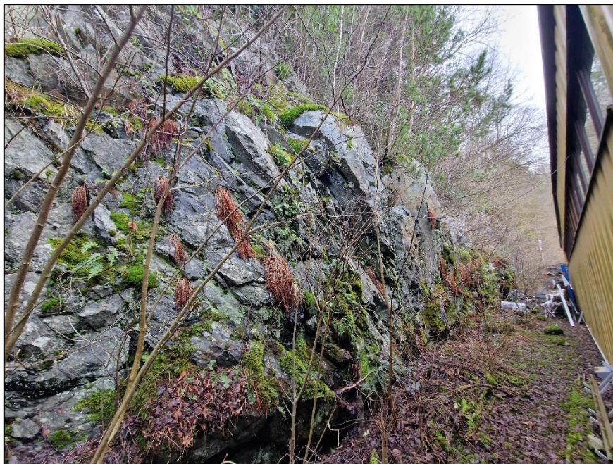
Figur 9. Nordlige del av skråningen har mer eksponert berg, men lavere fallhøyde. Her er det også observert steinsprang flere steder i grøften.
