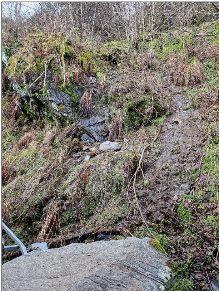
Figur 10. Utglidning av løsmasse- og vegetasjonsdekke som følge av steinsprang.
