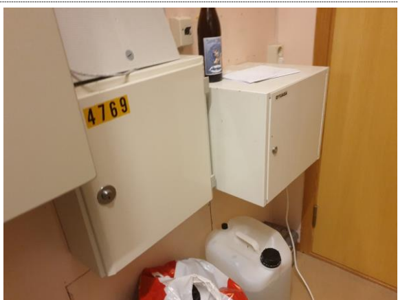
Bilde nr. 47 Sikringskap
