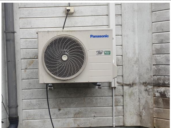
Bilde nr. 41 Varmepumpe - utedel
