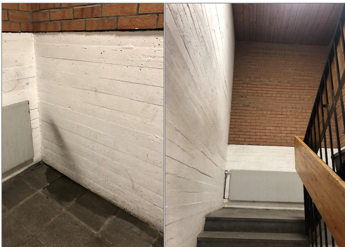
Figur 55. Eksempel på vedlikeholdsetterslep trapp
