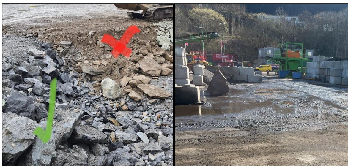
Figur 15: Tilkjøpte sprengsteinsmasser inneholdt jord (avvik 4). Rester av forurensede masser/filterkake i ren sone (avvik 10).
