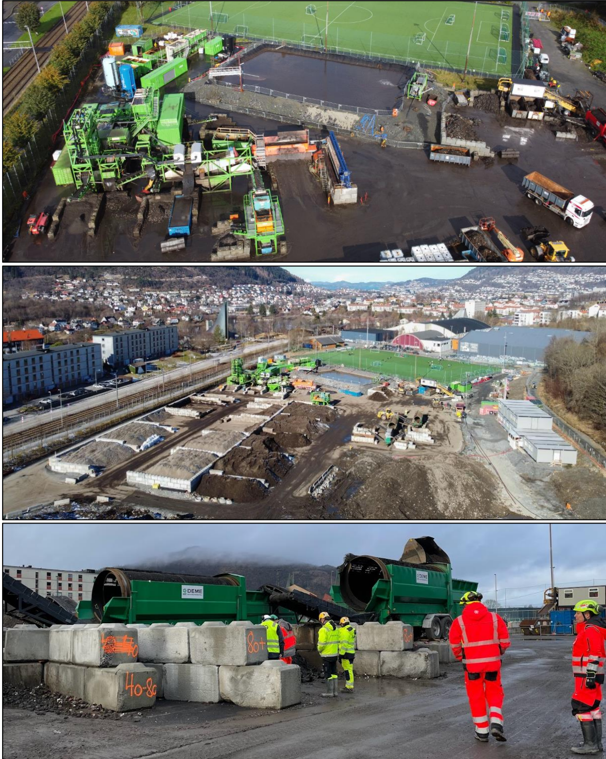
Figur 1: Dronefoto øverst er tatt mot nord av bufferbasseng, vannrenseanlegg og jordvaskeanlegg. Dronefoto i midten viser mottaksbåser for oppgravde og sorterte masser. Bildet nederst viser mottaksbåser for sortering i ulike fraksjoner.
