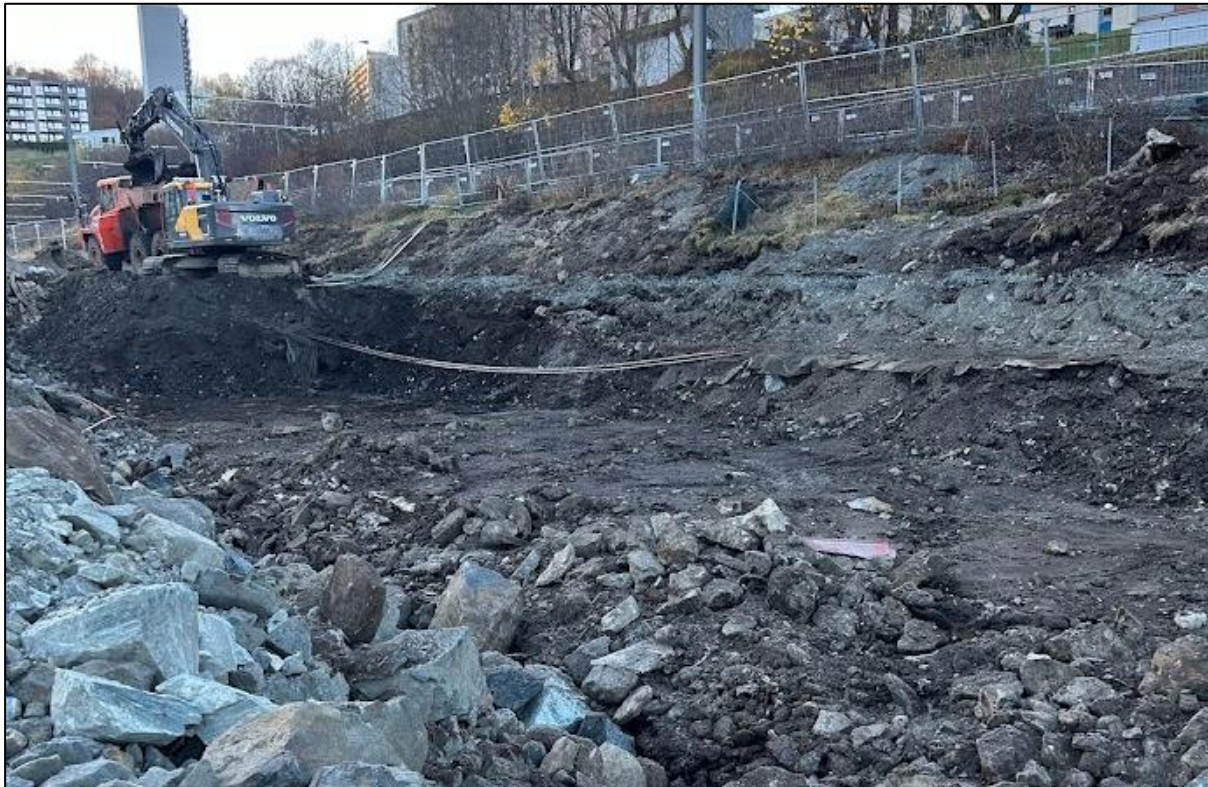
Figur 5: Bilde av masser langs Bybanetraséen tatt 14. november 2023. Masser med avfall og torv er ikke gravd ut for å unngå utglidning av Bybanesporet.
