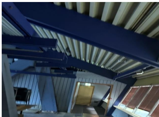
Bilde nr. 961.1 Eksponerte søyler. Skulle vært underkledd med branniheldig kledning. Forholdet må undersøkes nærmere
