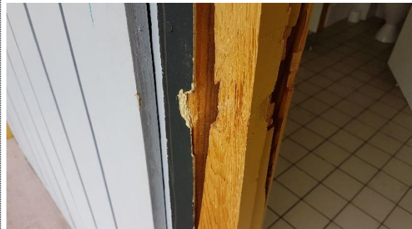
Bilde nr. 10 – Skade på svartmalt internitplate ved toalett i kafeareal.
