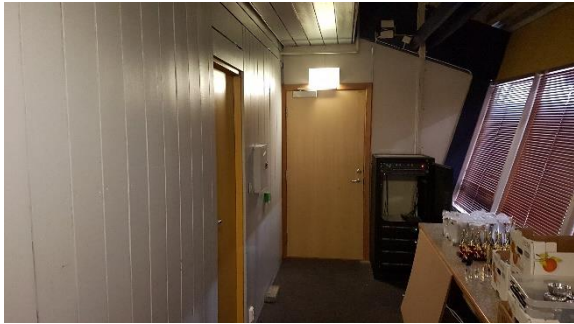
Bilde nr. 13 – Internit og eternit i flere rom ved kjøkken, mot hall.
