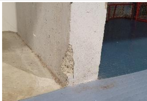
Bilde nr. 241.3 Skade i hjørnet på betongvegg
