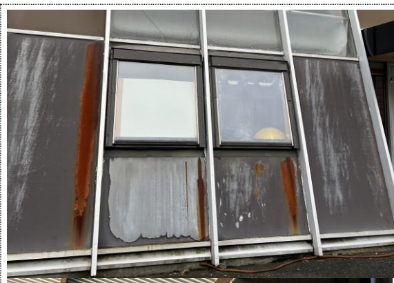
Bilde nr. 232.1 Fasade mot vest. Plater er misfarget og det har tidligere vært lekkasjer i fasaden.
