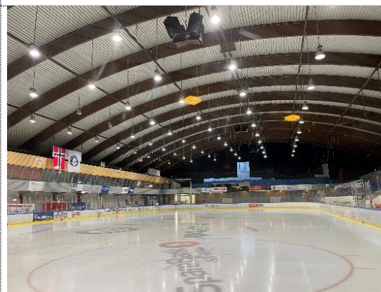
Bilde nr. 442.02 Noen defekte pærer
