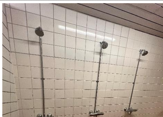
Bilde nr. 242.2 Fliser i garderobe. Øverste lag er nylig skiftet ut grunnet fukt bak tidligere fliser.
