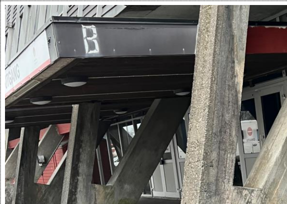
Bilde nr. 286.2 Eldre skjermtak bærer preg av fukt og slitasje.
