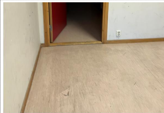
Bilde nr. 255.3 Gulvoverflate i tilbygg har en del bruksmerker
