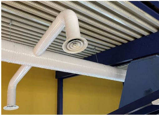
Bilde nr. 360.05 Nytt kanalnett tilknyttet aggregat i kafeen i 2.etg.
