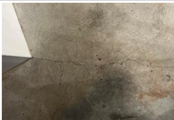
Bilde nr. 251.2 Betongdekker har generelt riss på overflaten
