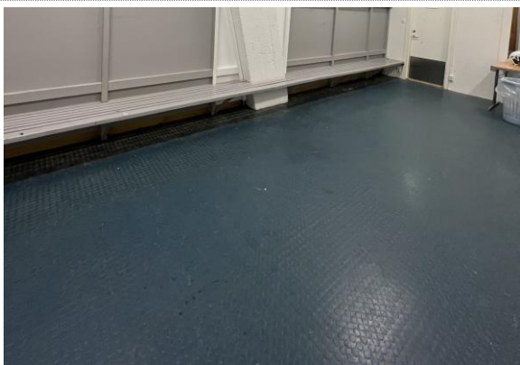
Bilde nr. 255.2 Gulvoverflater i garderobe er generelt i god stand.
