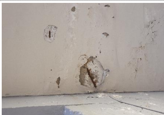
Bilde nr. 251.4 Synlig armering i tak.
