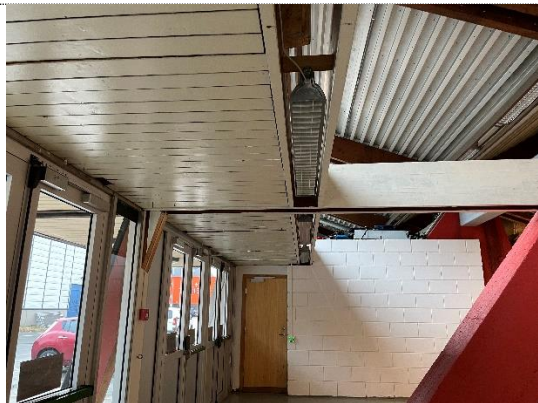
Bilde nr. 442.03 Inngangsparti. Eldre armaturer
