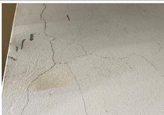
Bilde nr. 242.1 Registrert mye riss på innervegg på teknisk rom
