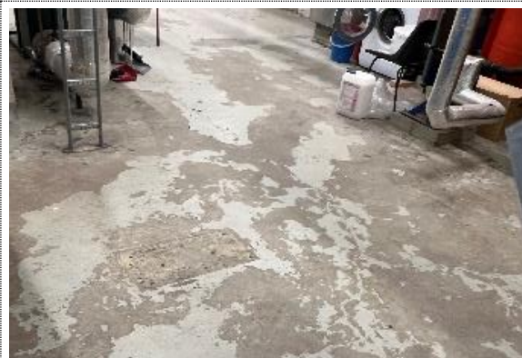
Bilde nr. 251.1 Gulv på teknisk rom er i dårlig stand og bør overflatebehandles.
