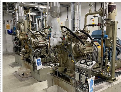
Bilde nr. 350.02 Kjølemaskiner fra 2005.
