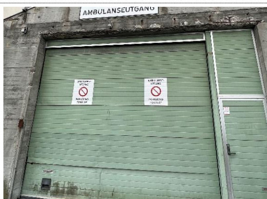
Bilde nr. 231.3 Synlig armering i overkant av port mot nord. Port bør vaskes
