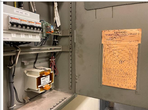
Bilde nr. 443.03 Nødlyssentral.
