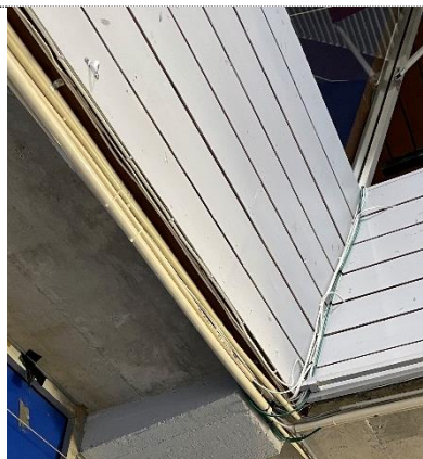
Bilde nr. 433.12 I hall. Senere kabelinstallasjoner stripset til opprinnelige installasjoner.
