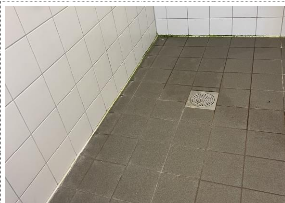
Bilde nr. 255.1 Mangel på renhold i garderobe i tilbygg.
