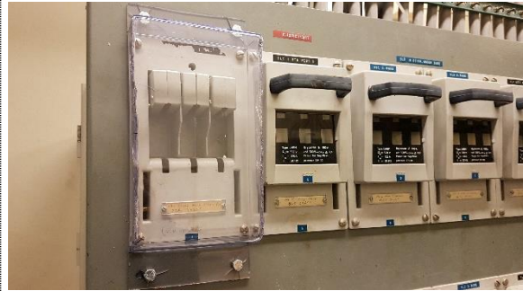
Bilde nr. 20 – Hovedtavle. Asbestholdige skilleplater i bryter til venstre.
