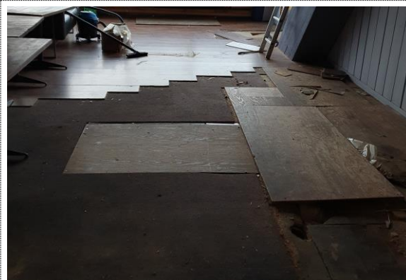
Bilde nr. 251.3 Lekkasje fra tak har ført til fuktig gulv i restauranten.
