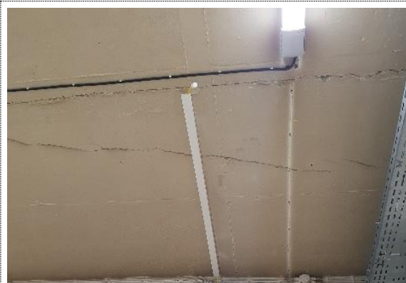
Bilde nr. 216.2 Sprekk i dekke i teknisk rom.
