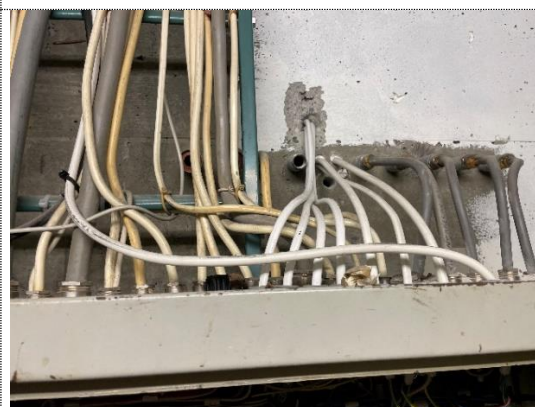
Bilde nr. 433.11 Kabelinstallasjon over tavle.
