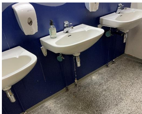
Bilde nr. 310.05 Eldre vannrør på toalett ved inngang B.
