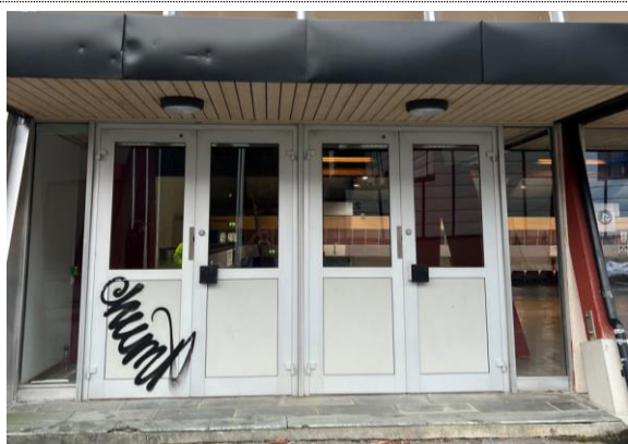
Bilde nr. 286.1 Nytt skjermtak. Råteskader i søyle utbedret etter 2013, ved å etablere oppstikkende fundament.
