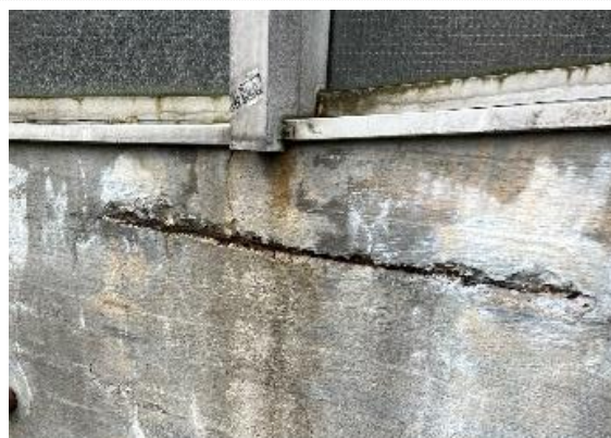
Bilde nr. 231.2 Synlig armering i yttervegg mot nord.
