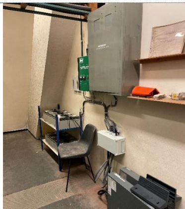
Bilde nr. 443.02 Nødlyssentral med batteribank og lader.
