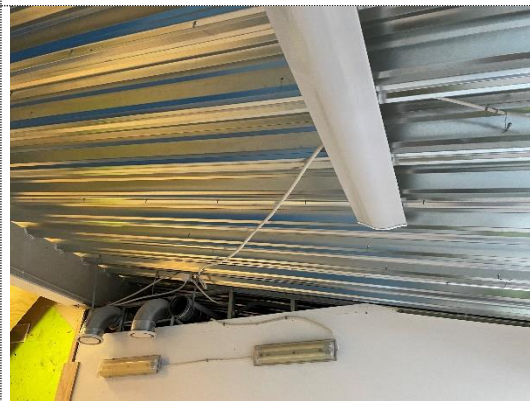
Bilde nr. 433.21 Løse/midlertidig festet kabel i tak.
