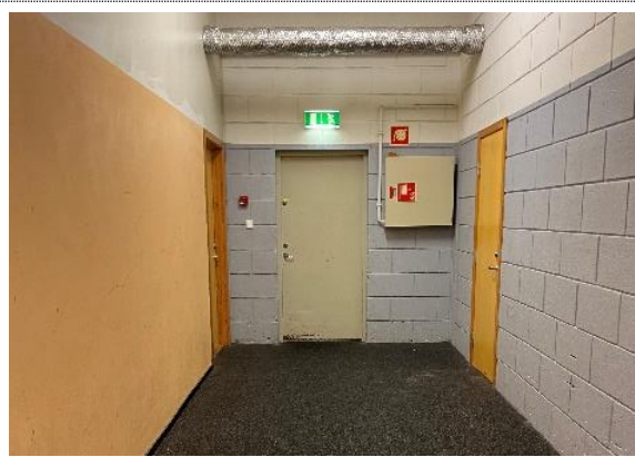
Bilde nr. 241.1 Overflate til innervegger er generelt slitt.
