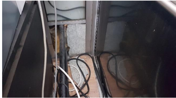
Bilde nr. 14 – Knust eternitplate i kontor i 1. etasje, vestside.
