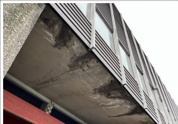
Bilde nr. 251.5 Utkraget dekke i fasade mot vest. Synlig armering.
