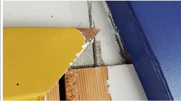
Bilde nr. 8 – Eternitplater i skillevegger ved kjøkken.
