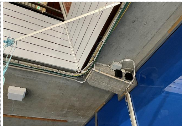
Bilde nr. 433.13 I hall. Senere kabelinstallasjoner stripset til opprinnelige installasjoner.
