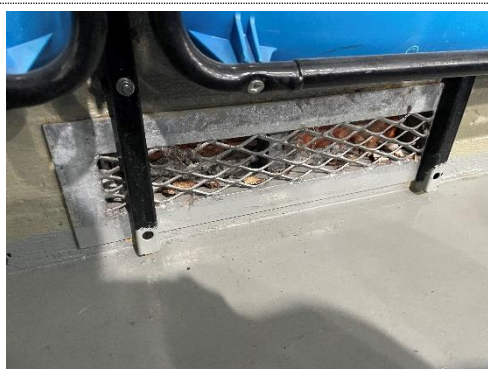
Bilde nr.360.03 Avtreksrister under tribune, tilknyttet ventilasjonsanlegg fra 1967.
