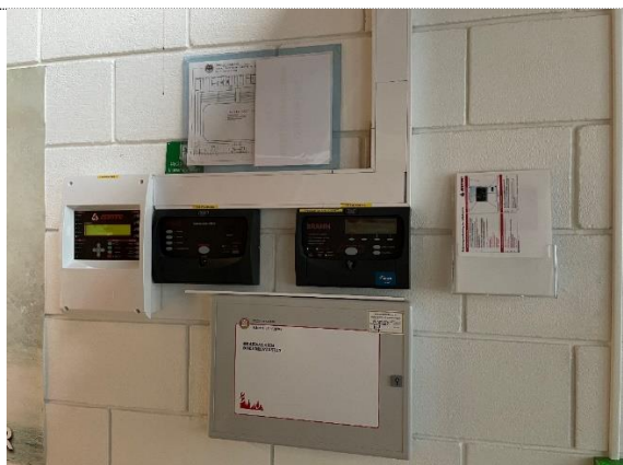
Bilde nr. 540.01 Brannalarmsentral i inngangsparti.
