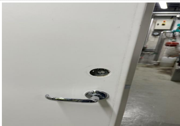
Bilde nr. 961.3 Låsekasse mangler i brann dør - må retableres
