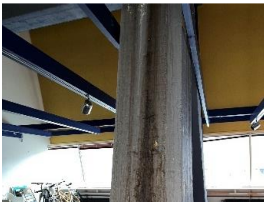
Bilde nr. 222.2 Innvendig betongsøyle. Det er renninger nedover søyler i restaurant og cafe
