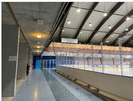
Bilde nr. 442.01 Defekte armaturer
