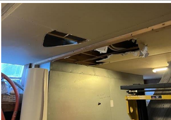
Bilde nr. 256.1 Skadet himling.
