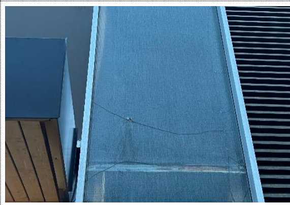
Bilde nr. 234.1 Det er sprekker i noen vinduer mot vest
