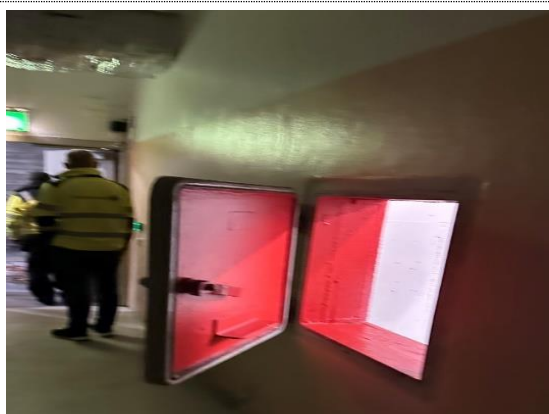
Bilde nr. 961.5 Uklassifisert luke fra tilfluktsrommet. Anbefales å etablere røykskille E 30 - CSa i korridor.
