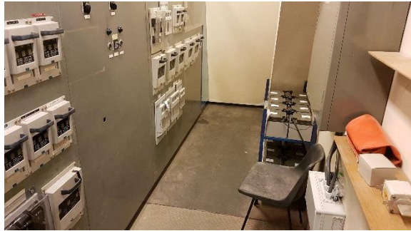
Bilde nr. 19 – Asbestholdige rikettfliser på gulv i tavlerom.
