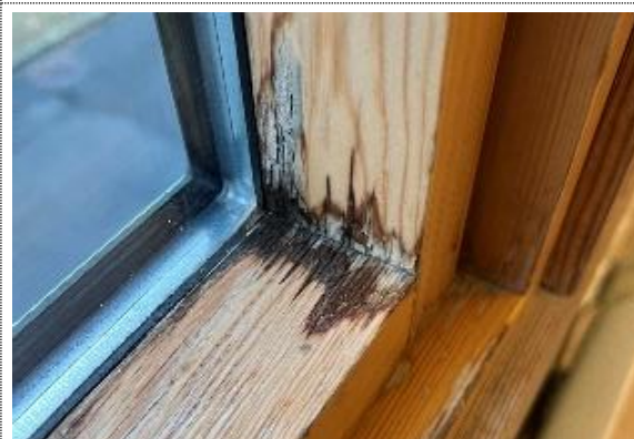
Bilde nr. 234.3 Vinduer i tilbygg har fuktskader i karm.
