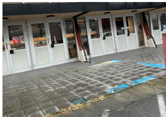
Bilde nr. 722.1 Hovedinngangsparti mot øst, skadet og misfarget flis.
