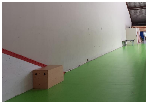
Bilde nr. 241.2 Bruksskader vegg i 2 etg mot påbygg.
