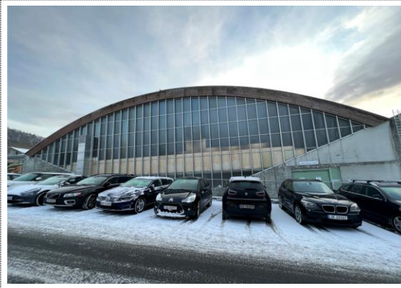
Bilde nr. 2.04 Fasade mot nord. Sprekker i noen vinduer
