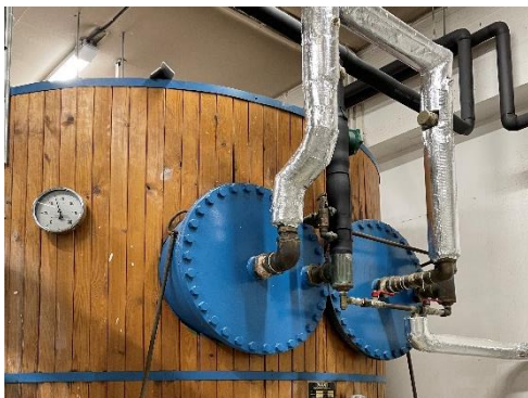
Bilde nr. 310.01 Etterisolert varmerør tilknyttet bereder fra byggeår 1967.
