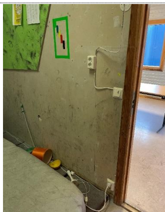
Bilde nr. 433.20 Klatrerom. Løse kabler.
