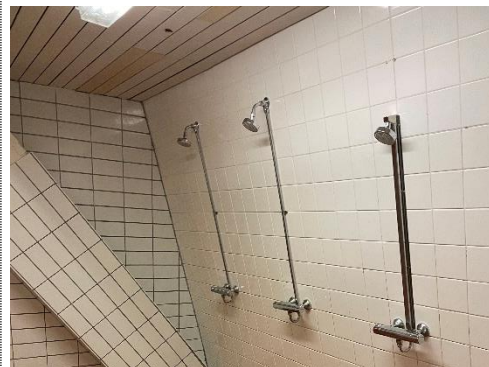
Bilde nr. 310.02 Dusjarmaturer i garderobe, blandebatteri byttet siden tilstandsvurdering i 2013
