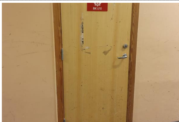
Bilde nr. 244.1 Dører er generelt slitt.
