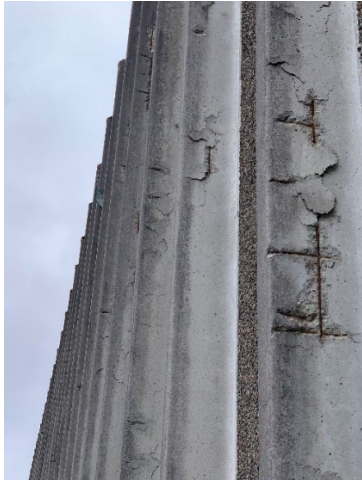
Figur 3-25 Detalj av oppsmuldet profilert betongfasade.
