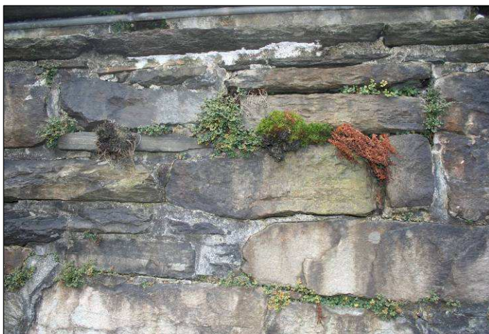
Fig 45. Ytterlivet i M9 er preget av begroing og sprukne sementfuger (foto: Byantikvaren 2009).
