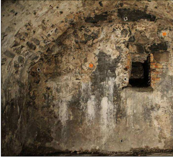
Fig 52. Det bevarte middelaldermurverket M4 er fuktskadet og innerlivet er konstant vått med oppløsningstendenser i puss og kalkfuger. Det er også betydelig saltutfelling i murverket (foto: Byantikvaren 2009).
