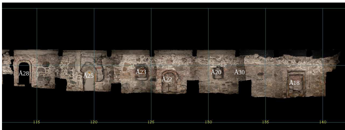
Fig 21. Innerlivet til den østlige langveggen (M3) i middelalderanlegget. Å med nummer markerer åpninger i murverket. De lysere partiene, særlig høyt på veggen, er kalkfuger etter reparasjoner på 1980-tallet (tilrettelagt illustrasjon fra fotogrammetriprosjektet, Marcin Gladki 2009).
