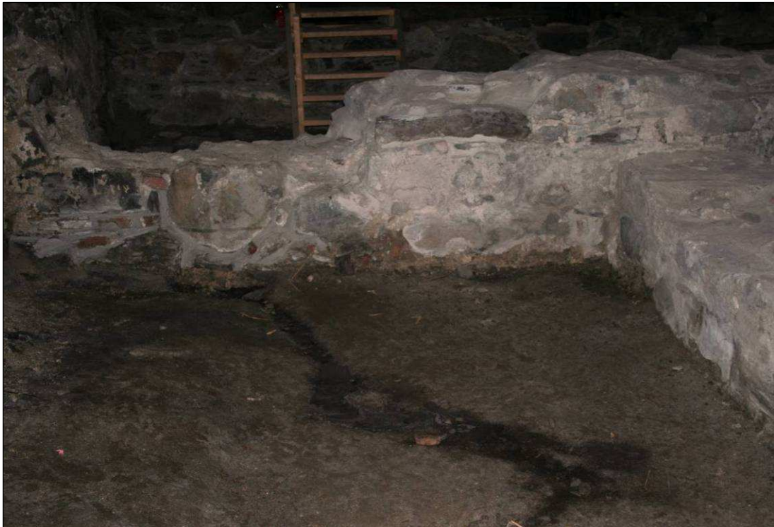
Fig 31. Vannsig fra under murverket i M16 absorberes i undergrunnen i rom 11 (foto: Byantikvaren 2009).
