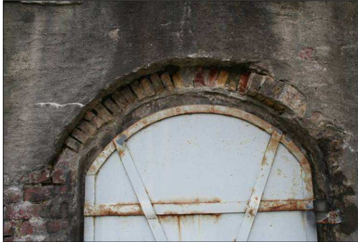
Fig 49. Teglforingen i rundbuen over portalen (Å16) er i dårlig stand (foto: Byantikvaren 2009).
