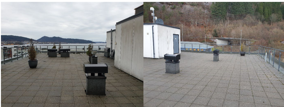
FIGUR 3 Bilder tatt på takterrassen til Sandviksveien 94. Bilde t.v. er tatt vestover, bildet t.h. er tatt østover
