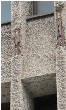
Figur 4: Typisk nivå utfall betong
