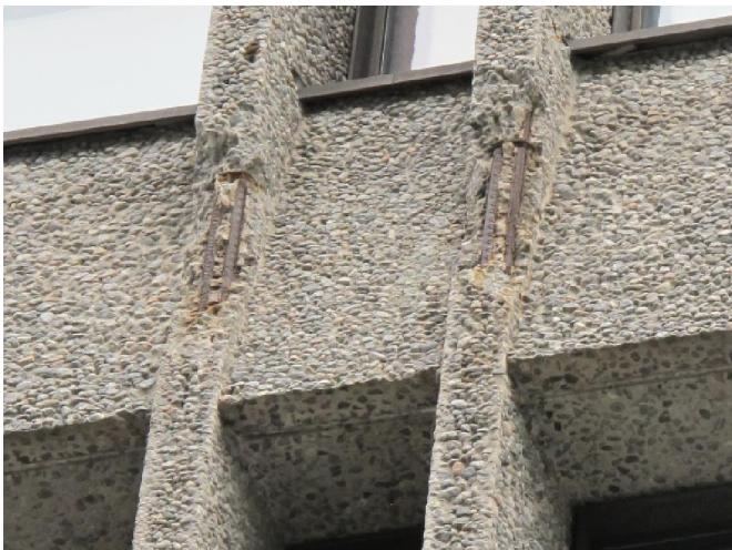
Figur 3: Typiske registrerte skader
