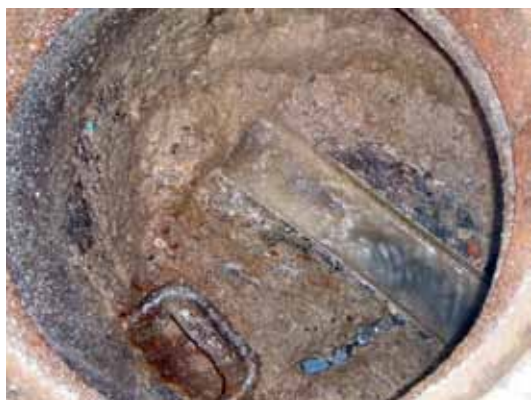
Kummer og stikkledninger gjengrodd av fett.
