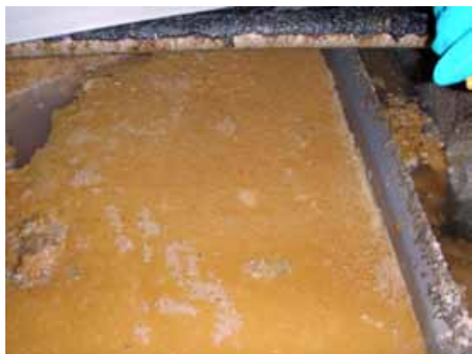
Eksempel på fettutskillere som ikke er driftet riktig.
